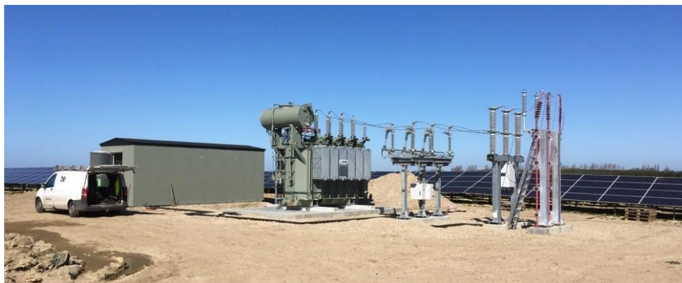
Figur 1-6 Eksempel på stepup-transformer og en teknikbygning.
