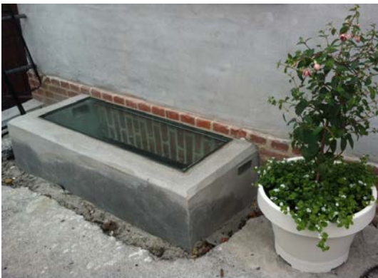
Lyskasse med skybrudssikring og glas
