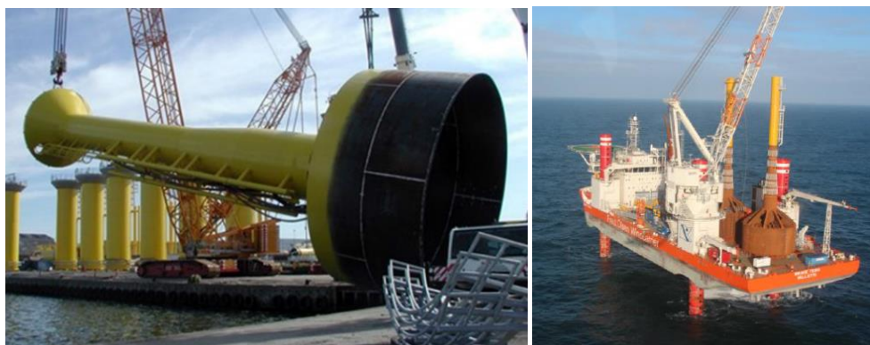
Figur 5.4.5 Sugebøttefundament på land (venstre) samt ombord på installationsskib (højre). Billederne er fra etableringen af en vejrstation i tilknytning til Horns Rev II Havmøllepark. (Kilde: Universal Foundations)
