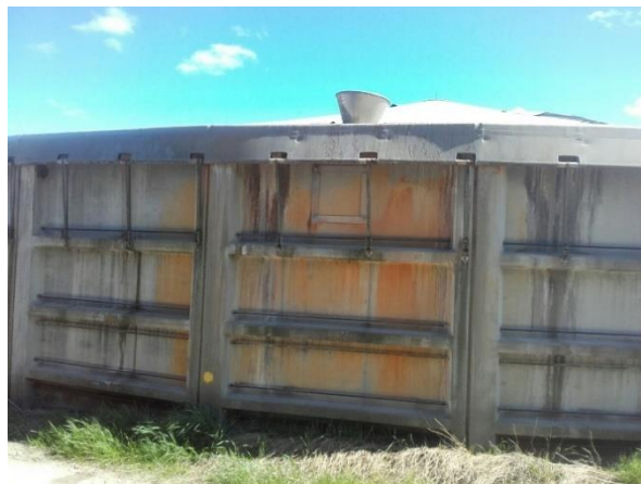
Biogasanlæggets produktion (afsug, luftren-
