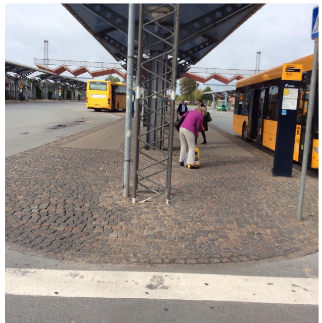
Foto 28: Adgang til bus-ø er anlagt i ujævne chaussésten.
